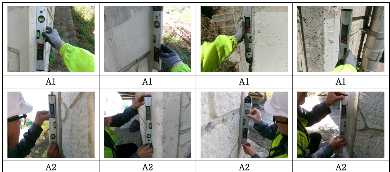
【사진 3.3.10】 교대 기울음 측정 현황
